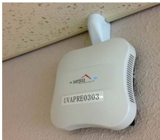
図- 3: 無線ネットワーク基地局の設置例
